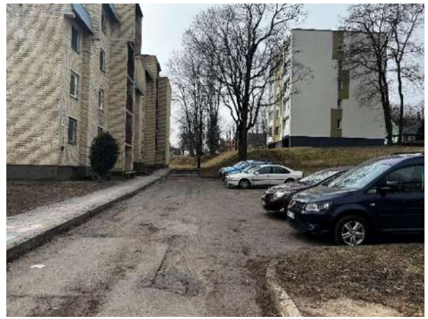
Vytauto skg. 7 automobilių stovėjimo aikštelė. Asfalto, betoninių plytelių danga nusidevėjusi.
