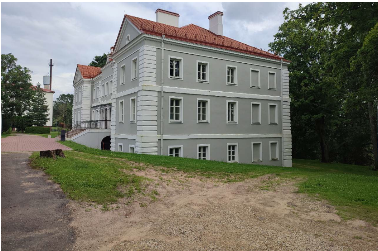
Vaizdas nuo V pusės. Dėl neįrengtos atsparios dangos aplinkui pastatą vyksta šlaito erozijos procesas
